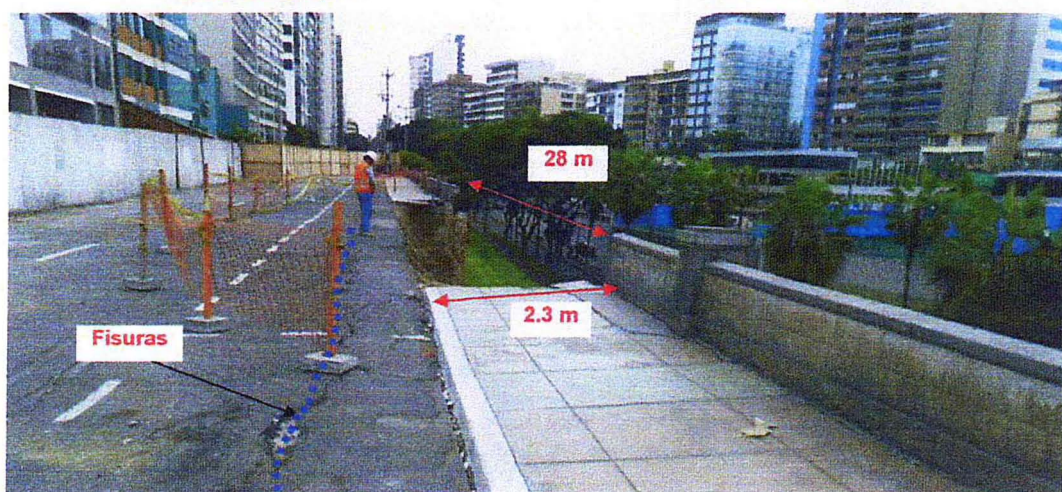
Fotos N° 3: Identificación de la zona del colapso
