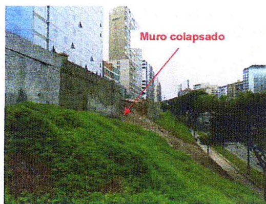
Después del colapso
