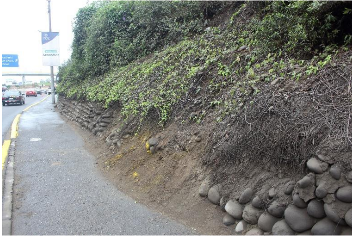
Figura 49. Vista de muro de protección deteriorado.
