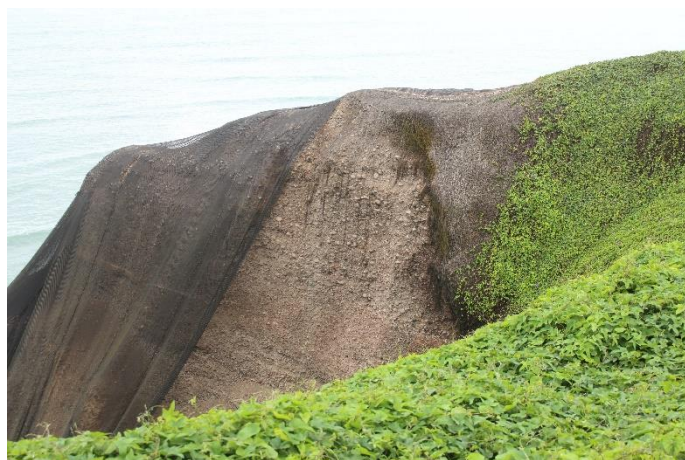
Figura 53. Zona expuesta sin geomallas ni cubierta vegetal
