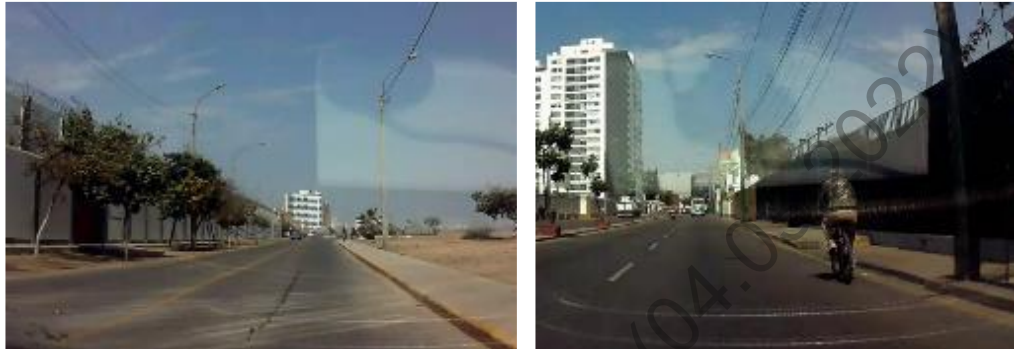
Foto N° 01/II.6.4: Estado de calzada y vereda
