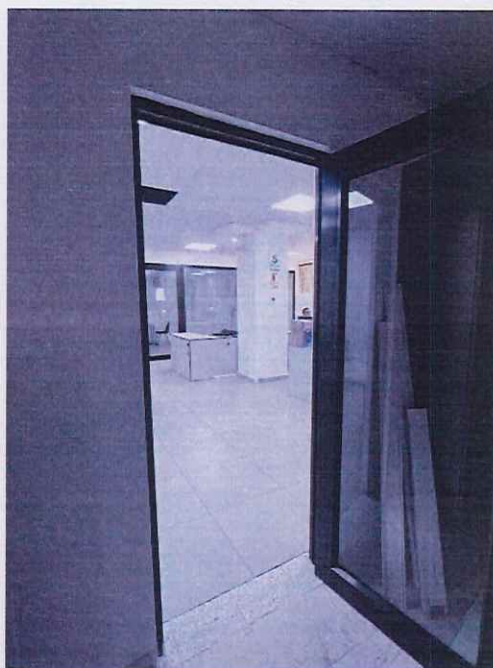
Imagen 08: Foto propia del ingreso al DATA CENTER.
