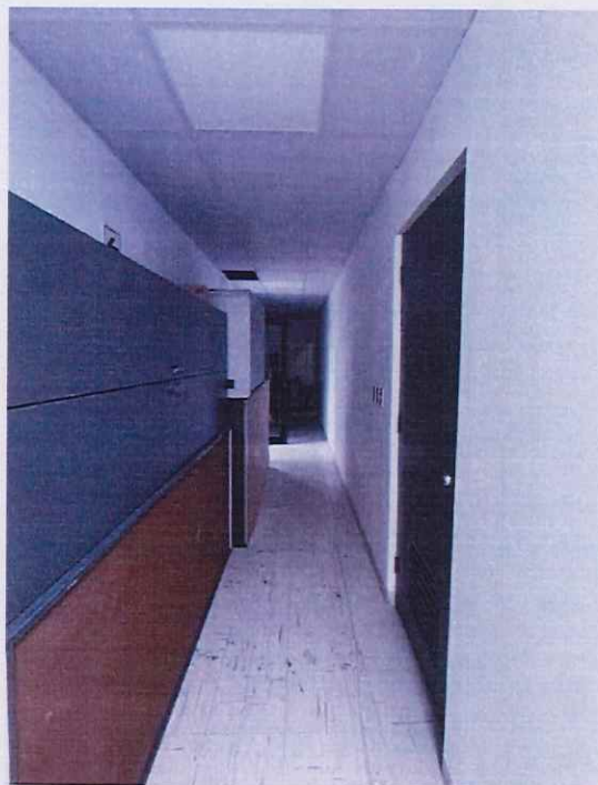
Imagen 07: Foto propia del corredor al DATA CENTER.
