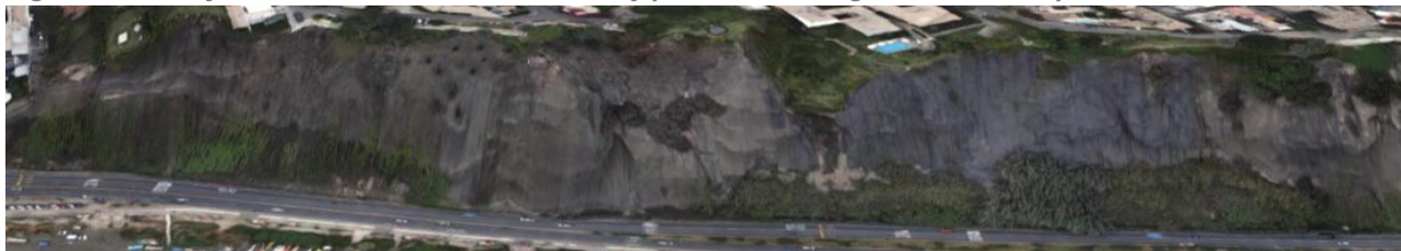
Figura 99. Trabajo de enmallado con enredaderas y presencia de vegetación carrizo por humedad en el talud.
