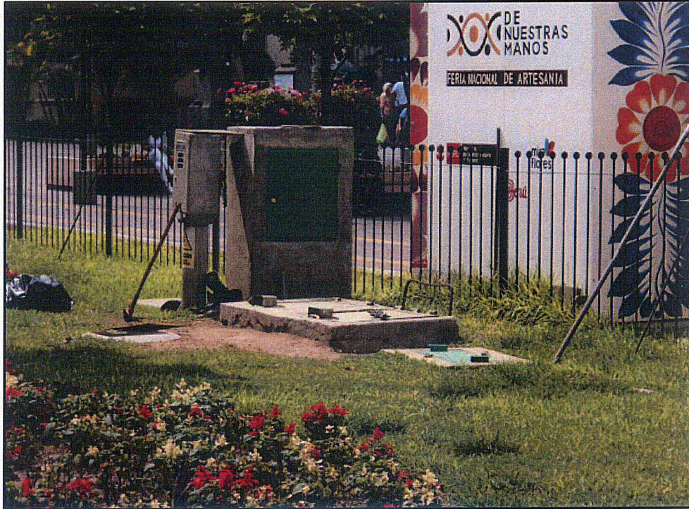
Foto N°17; Vista de luminaria en piso, portico de ingreso al parque 7 de Junio.
