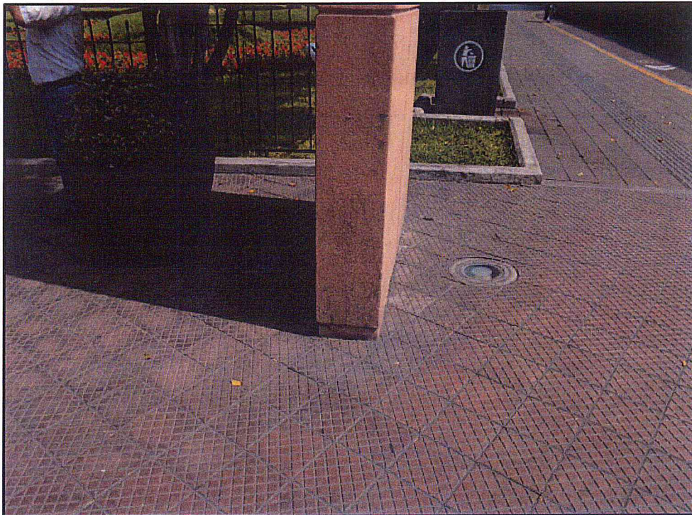
Foto N°11; Vista de luminaria en piso, portico de ingreso al parque 7 de Junio.
