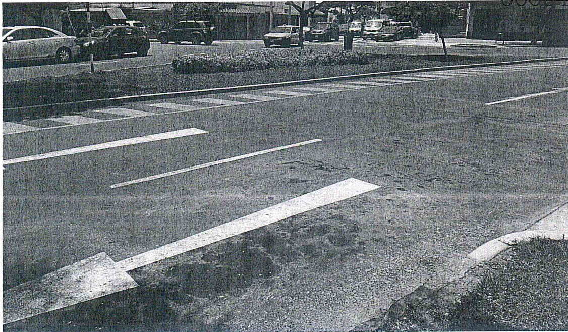
Fotografía 93.- Estado de sardineles y pista de la calle Vargas Machuca –Cdra. 3.
