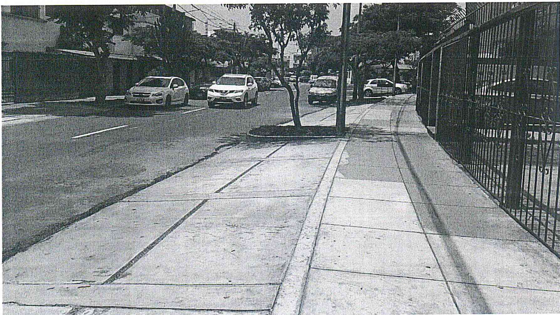
Fotografía 92.- Estado de berma y pista de la calle Vargas Machuca -Cdra. 3.
