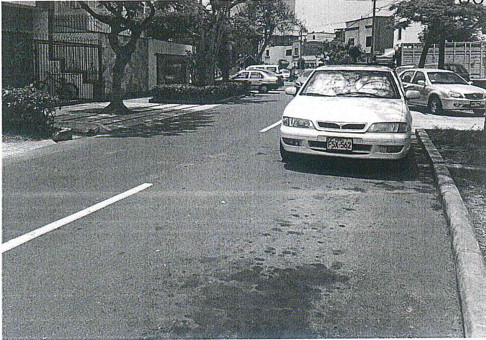
Fotografía 91.- Estado de sardinel y pista de la calle Vargas Machuca -Cdra. 2.
