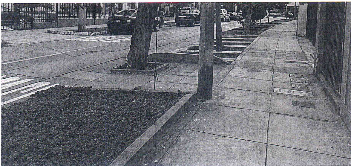
Fotografía 74. Detalle de la condición de veredas y pista en la Cdra. 2 de Ca. Ortiz De Cevallos.
