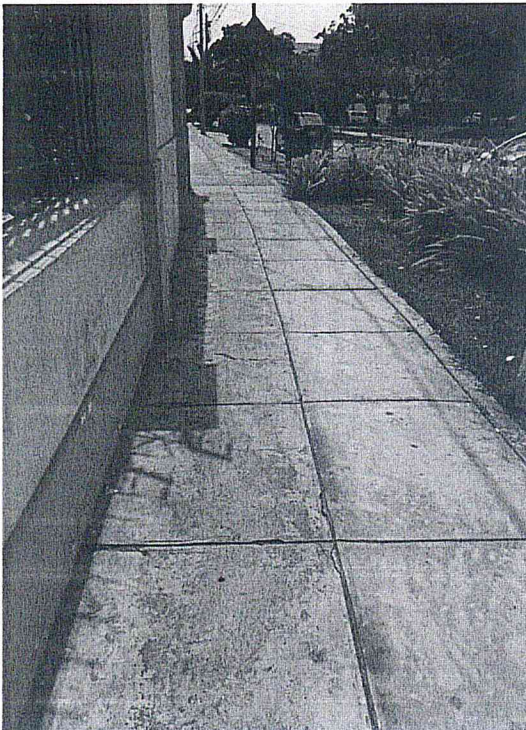
Fotografías 12 -14. Estado actual de la pista, berma y veredas de la calle Bartolomé Trujillo, cdra. N° 1.
