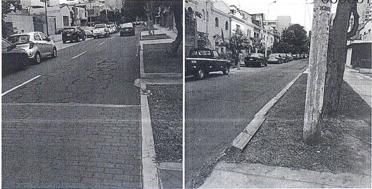
Fotografías 58-59. Detalle de la condición de las pistas, veredas y jardineras de las Cdras. 1 y 2 de Ca. Mariano Odicio.
