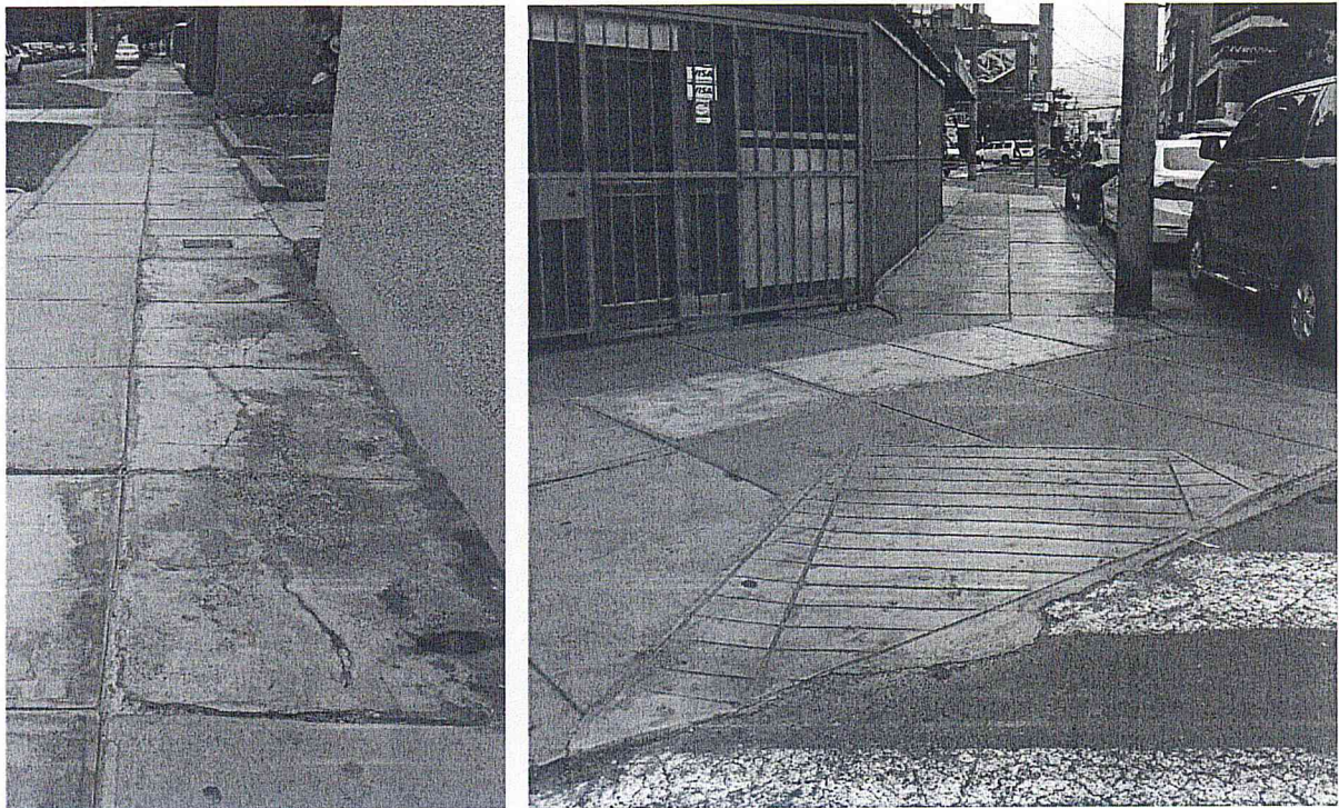
Fotografías 60-61. Detalle de la condición de las veredas y rampa de las Cdras. 1 y 2 de Ca. Mariano Odicio.
